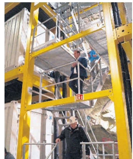
Die 17 m hohen Felskammern lassen es zu, drei IT-Container übereinanderzustellen. Foto: C. Böckmann
