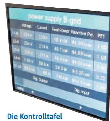
Die Kontrolltafel im Containerinneren gibt Aufschluss über alle wichtigen Daten. Foto: C. Böckmann
